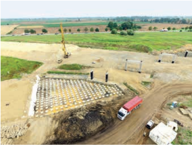
Droga P-14 w km 0 + 800 (najazd na obiekt WD-18) – wzmocnienie podłoża w technologii żelbetowych pali formowanych w gruncie metodą przemieszczeniową, zwieńczone oczepami
