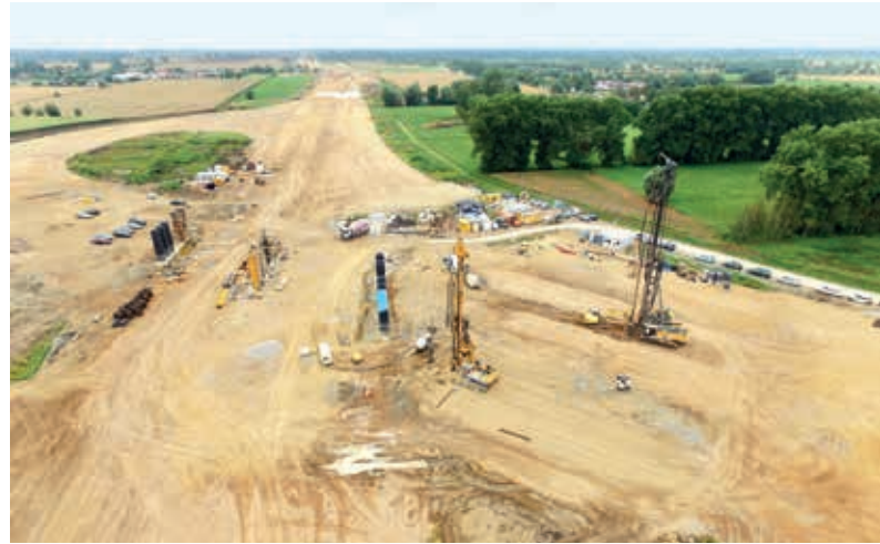
Droga S7 w km 55 + 400 – wzmocnianie podłoża w technologii żelbetowych pali formowanych w gruncie metodą przemieszczeniową (najazd na obiekt WD-26), zarys węzła Elbląg Zachód
