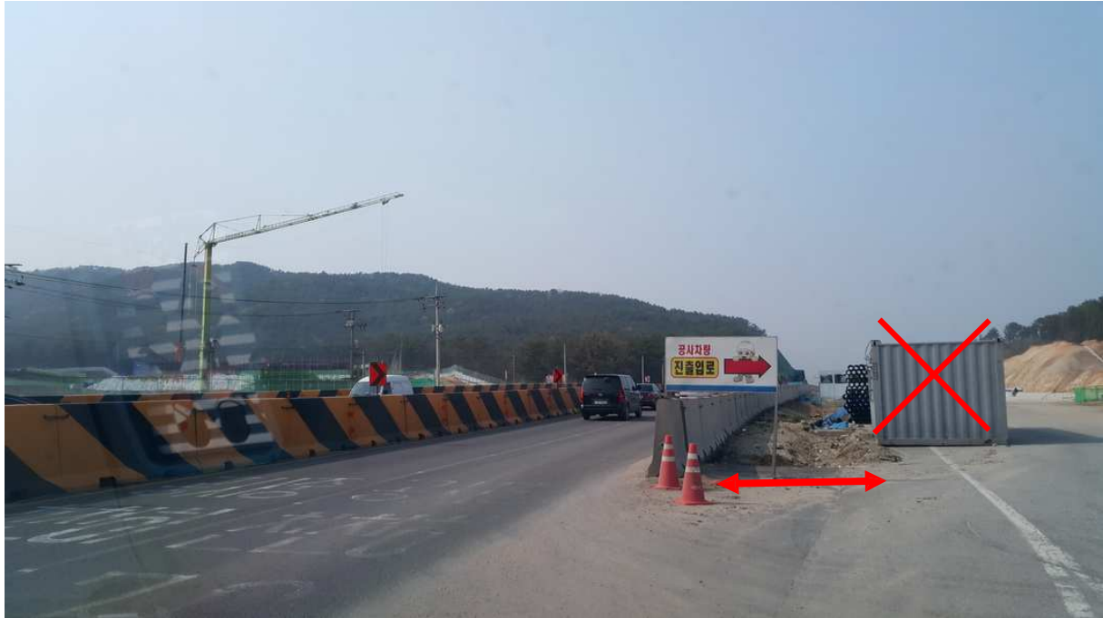
Ilustracja 4. Niebezpieczne praktyki w zakresie umiejscowienia kontenerów na terenie budowy: pomimo obecności betonowych barier.
